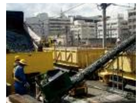
写真7：装置の使用状況
